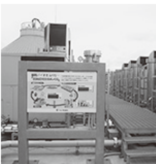
消化ガス発電所 (鶴岡バイオガスパワー)
