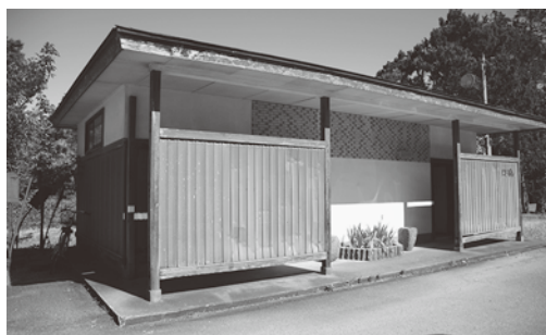
老朽化が進んでいる善寶寺の公衆トイレ
